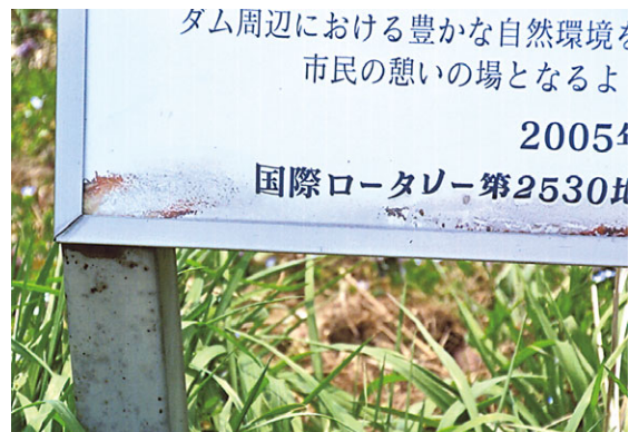
下方が腐蝕しているのが分かります。
